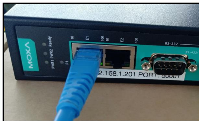
รูปที่ ๕๑ สาย LAN เชื่อมต่อกับอุปกรณ์แปลงสัญญาณ (MOXA)
